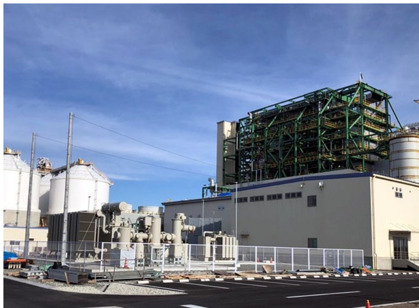
米子バイオマス発電所
