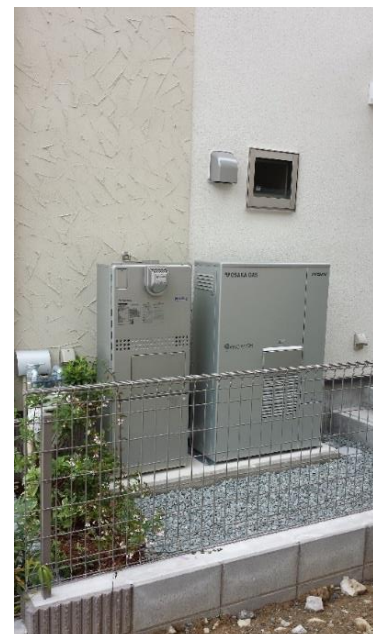
エネファーム導入部
