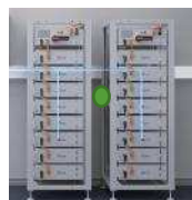
<蓄電> 蓄電池 約 60kW
