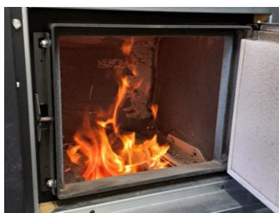
バイオマスボイラー
