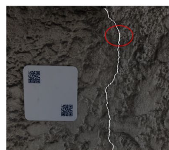
③ クラックを合成 ※外壁のどの部分が最大幅であるかが判明します。
