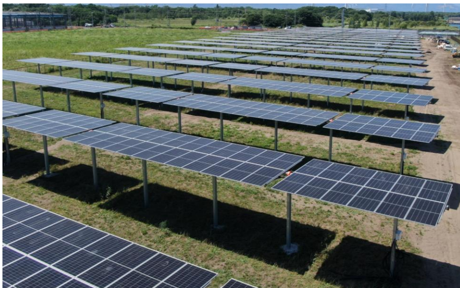
石狩地域エネルギー合同会社にて開発を進めている（仮）北海道石狩第二太陽光発電所
