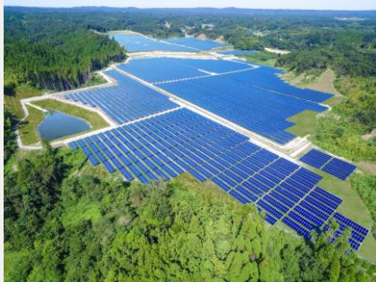
リエネ長南太陽光発電所 (千葉県) 定格容量：24MW
